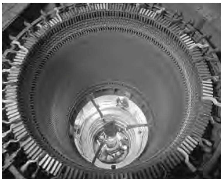
Photo 7.6 EDF. Centrale hydraulique de la Coche
