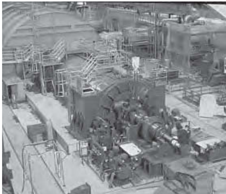
Photo 7.8 EDF. Salle des machines de la centrale nucléaire de Saint-Laurent des Eaux.
